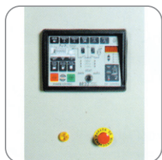
TTA (Tablero de Transferencia y Arranque Automático)
